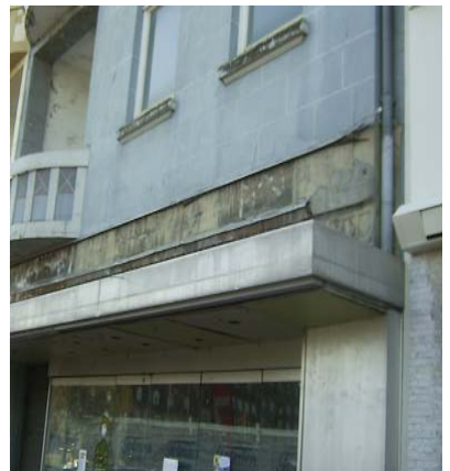
Leider lassen die Eigentümer des Hauses Nr. 8 die Fassade des Gebäudes völlig verkommen
